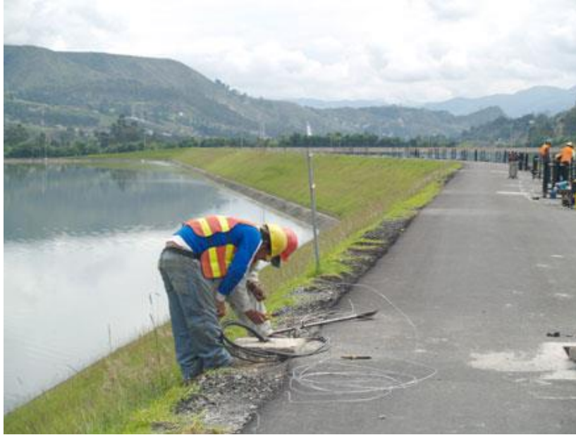
Foto 1. Se proyecta la construcción de la nueva planta de tratamiento que servirá a 3 ciudades andinas.
