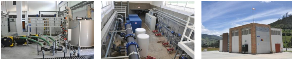
Fotos 18, 19 y 20. Planta potabilizadora de Sustag, la más actual que trata el agua de la ciudad de Cuenca.
